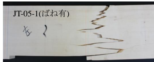
図4 貫下端の切り欠きによる割裂破壊
